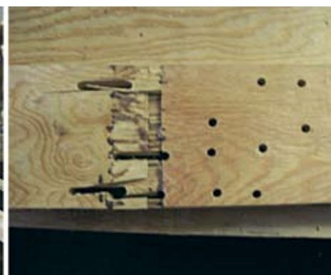
Рис. 7. Разрушение узла нижнего пояса от скальвания
