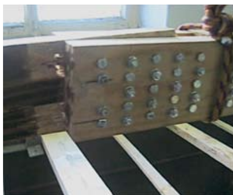
Рис. 6. Разрушение конструкции в накладках нижнего пояса от скальвания
