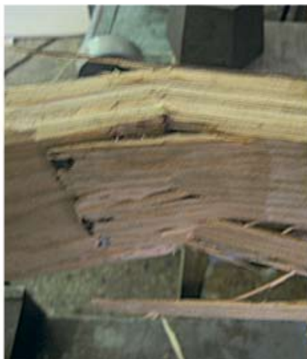
Рис. 5. Фотофиксация разрушения верхнего пояса
